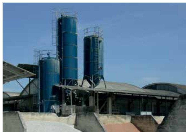
Impianto di betonaggio centralizzato.
